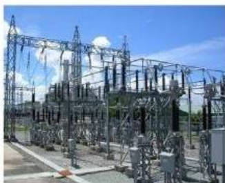
ลานไฟฟ้า
